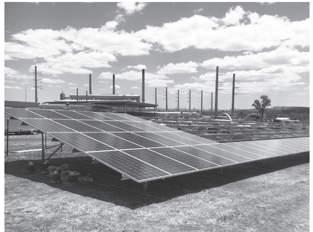
โรงไฟฟ้าพลังงานแสงอาทิตย์คอลลินสวิลล์ กำลังการผลิต 42.5 เมกะวัตต์ รัฐควีนสแลนด์ ประเทศออสเตรเลีย
